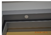
Door position switch REX Sensor
